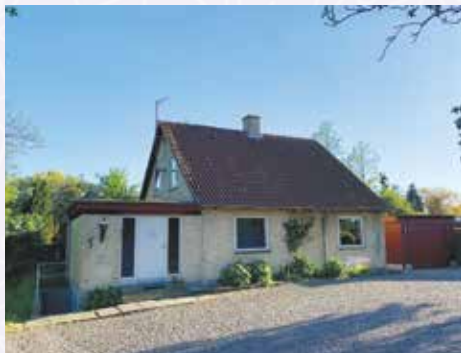
Sognehuset skal have ordnet kloakken
